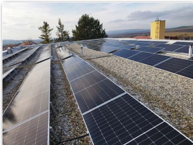
Fotovoltaická elektrárna na střeše budovy ZŠ
