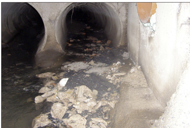
Písek v kanalizační šachtě u rybníčka.
